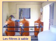
Les filtres à sable
